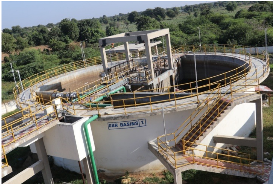
4.1 MLD & 2.9 MLD STPs – Vijapur
